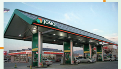
太陽光発電パネル設置 JOMOステーション
