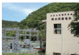
柿の沢発電所
